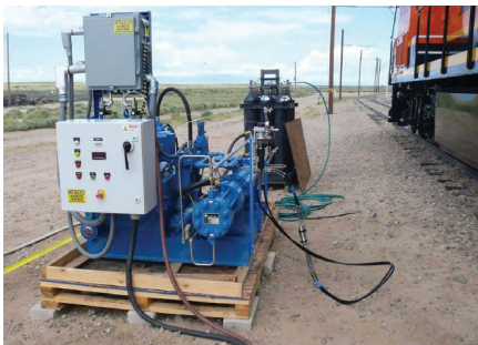
Рис. 12. Заправочная станция водородного локомотива
