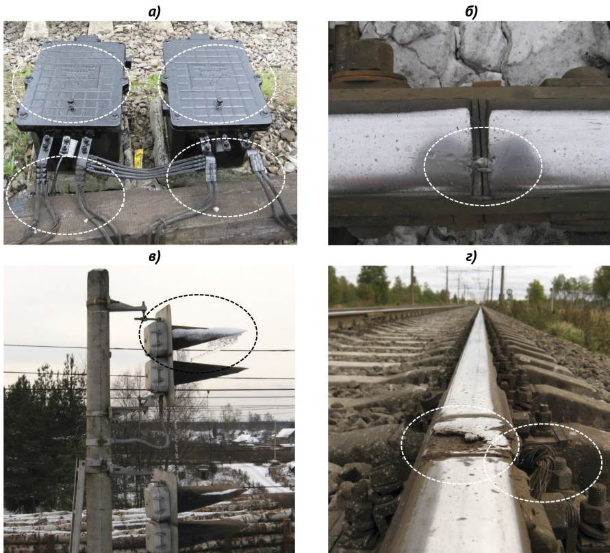
Рис. 10. Некоторые дефекты устройств и элементов напольной автоматизации: а – приведены два дроссель-трансформатора, у которых нет маркировки, отсутствуют вешки, не окрашены дроссельные перемычки; б – приведена окалина на изолирующем стыке; в – приведен козырек светофора, с которого свисает лед, перекрывая показание сигнала; г – скол на рельсе и повреждение стыкового соединителя
