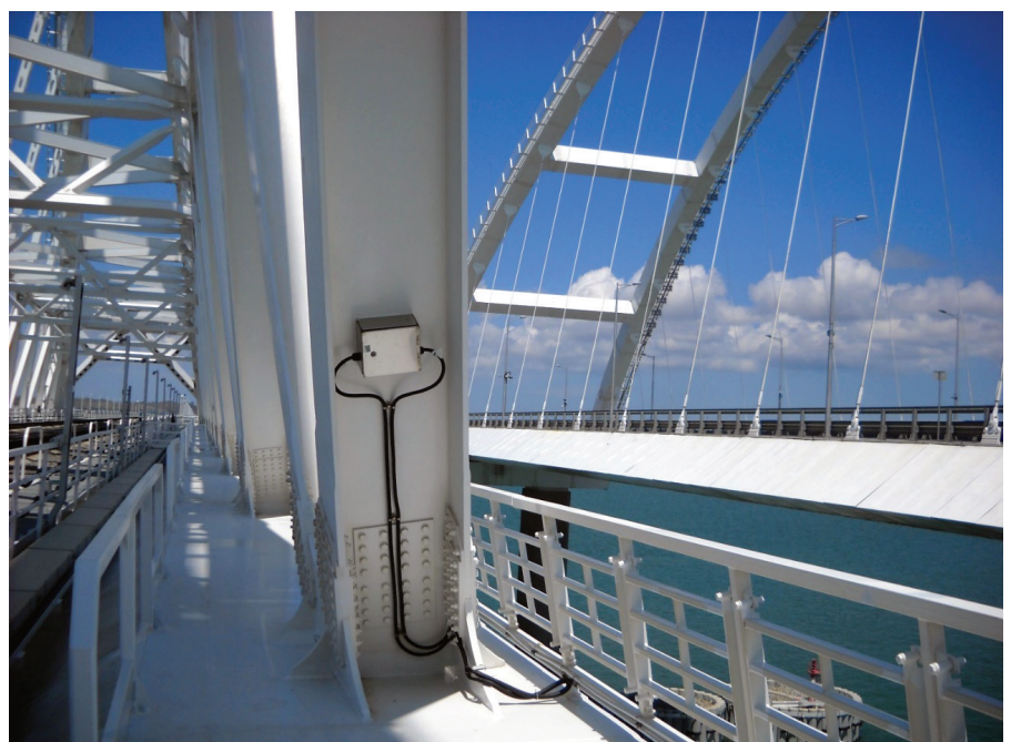
Рис. 2. Смонтированный на арке железнодорожного моста шкаф с аналого-цифровым преобразователем
